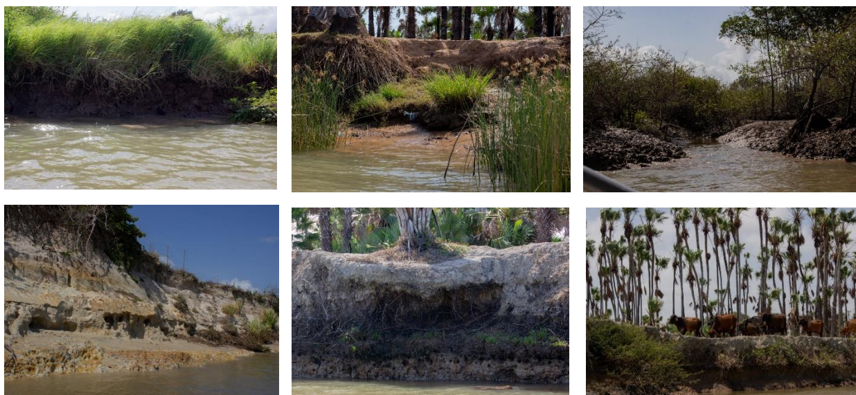
Figura 17 - Processos erosivos encontrados na área ribeirinha do Rio Igarçu
