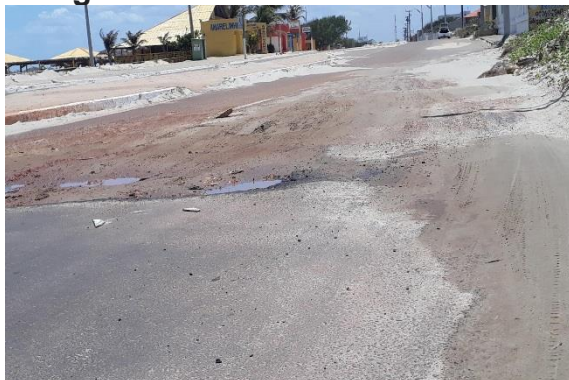
Figura 15 - Buracos na via da orla
