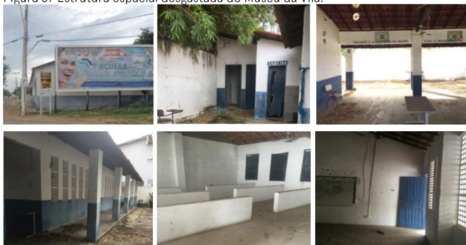
Figura 57 Estrutura espacial desgastada do Museu da Vila.
