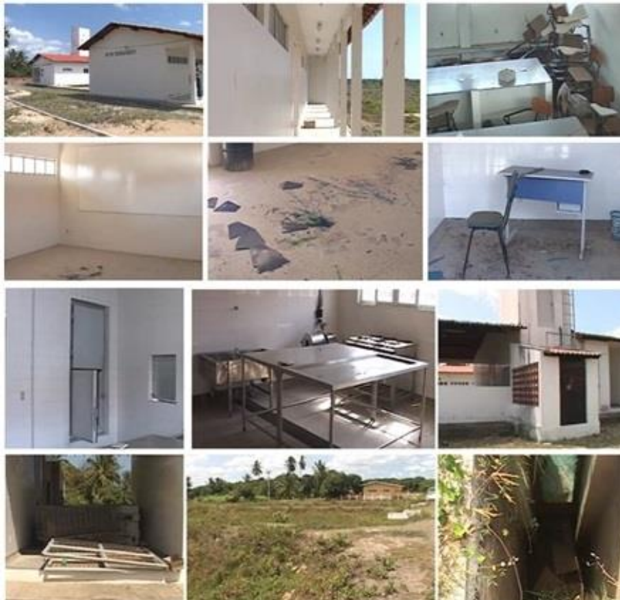
Figura 24 Prédios e Salas que integravam a antiga Estação de Piscicultura em situação de abandono.
